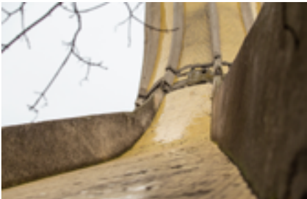
↑ Punct CET dezafectat, degradare a finisajului exterior
