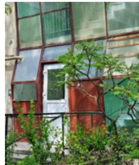
↑ Înlocuire a ușii originale cu o materialitate și cromatică inadecvată
