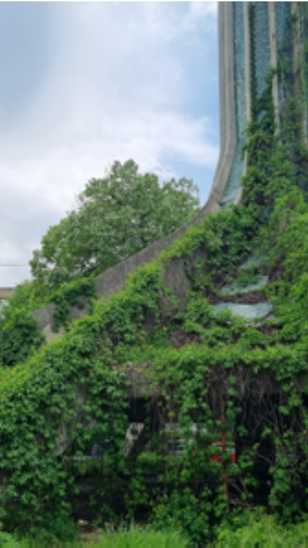
↑ Punct CET dezafectat, cu un grad avansat de degradare
